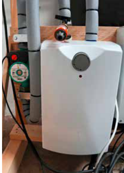
Heizungsanlage: Boiler und Wasserpumpe.
