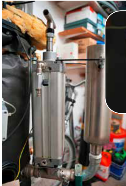
Hier ist die Befüllereinrichtung zu sehen.
